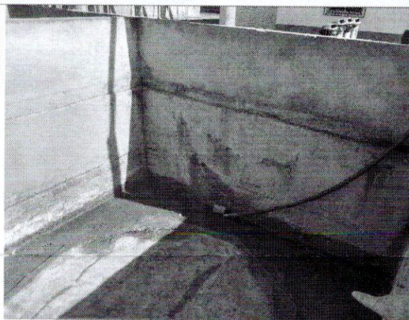
Figura 11 – Contenção do tanque de ácido sulfúrico.
