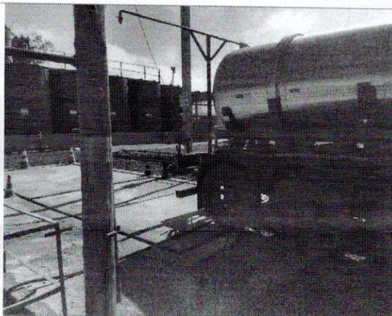
Figura 8 – Tanque para armazenagem de ácido sulfúrico .
